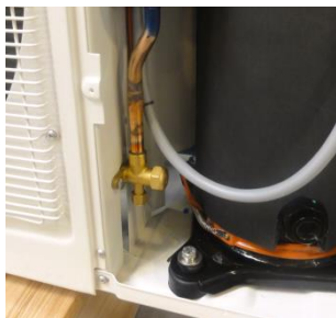
Figura 27: Puerto de servicio de la línea de líquido
